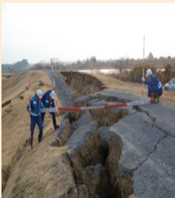
図2：鳴瀬川河川堤防の被害
