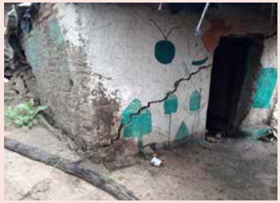
الصورة 4: منزل نازح (كاس) متضرر بشدة في جنوب دارفور. مصدر الصورة: CAH & AHCO الميدانيين
