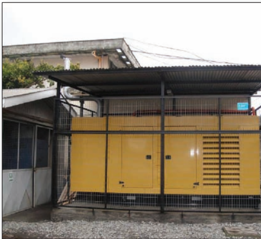
Figura 13. Grupo electrógeno. Hospital Las Higueras. Talcahuano. Región del Bio Bio.
