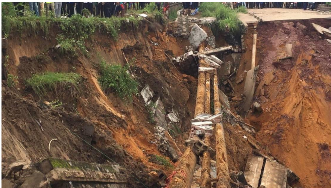
Figure 3 : Effondrement de terrain provoqué par des pluies diluviennes dans le quartier de Lemba à Kinshasa le 26 novembre 2019© AFP/Manu Kalombo
