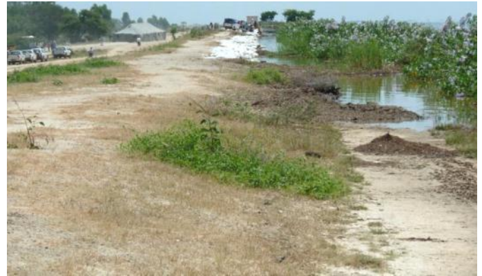
Figure 9. Arrachements pour la recherche de vers de terre (i.e. appât pour la pêche), érosion hydrique et réparations avec des sacs de sable près de la prise P1; Maga; 28 septembre 2012.
