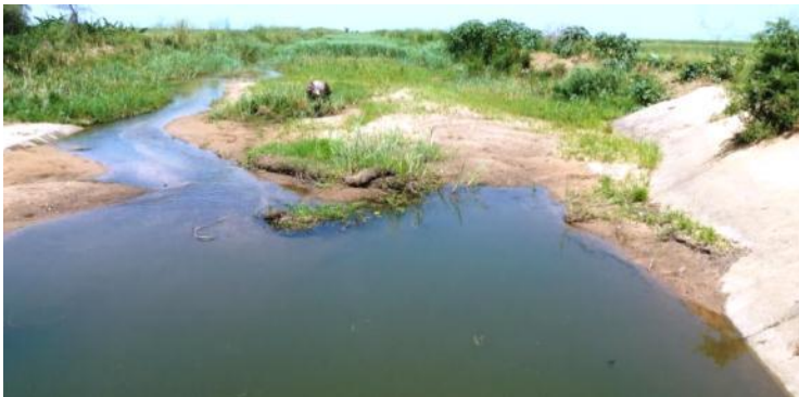
Figure 17. Canal primaire d'irrigation P4 couvert de végétation et de sédiments.
