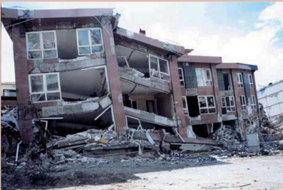
Figura 1 del caso de estudio Daños en las viviendas
