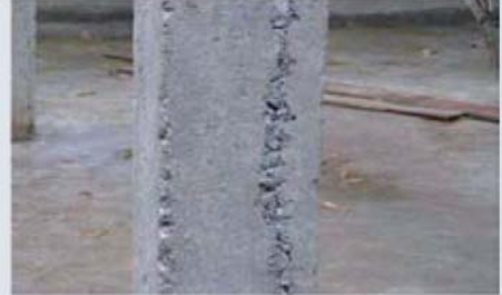
Figura 3.5 El «efecto panel» evidencia una construcción de mala calidad
