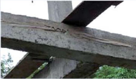
Figura 3.4 Desechos incrustados en una viga de soporte de hormigón
