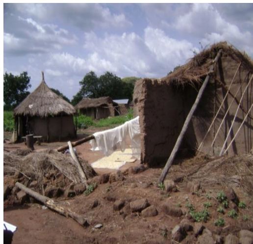
Cases en banco et paille détruites à Tokpli
