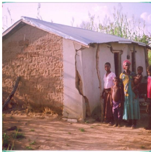
Habitat rural endommagé à Aklakou
