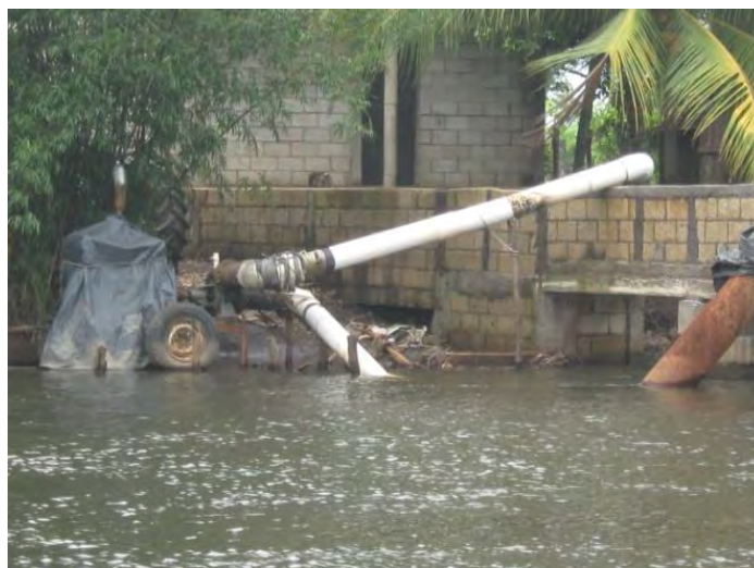
Foto 10: Agua y Saneamiento, Sistema de captación en el Puerto de Izcapa dañado
