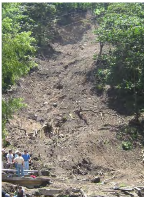
Foto 7: Agua y Saneamiento, Deslizamiento de talud sobre la captación de agua en el municipio de San Vicente de Pacaya
