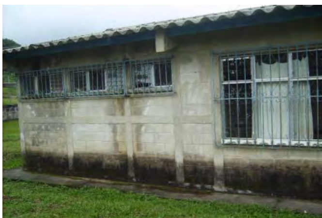
Foto 4: Salud, Puesto de Salud El Rodeo, Escuintla afectado
