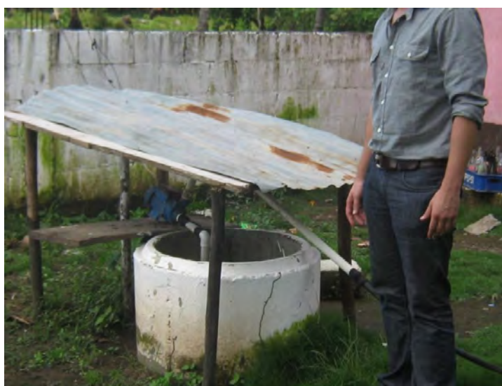
Foto 9: Agua y Saneamiento, Pozos en Puerto San José, Iztapa.
