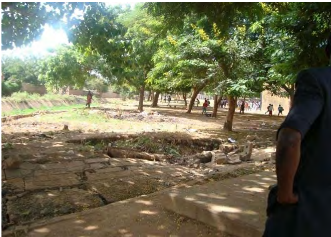
Figure 9: Le mur d'un établissement scolaire écroulé
