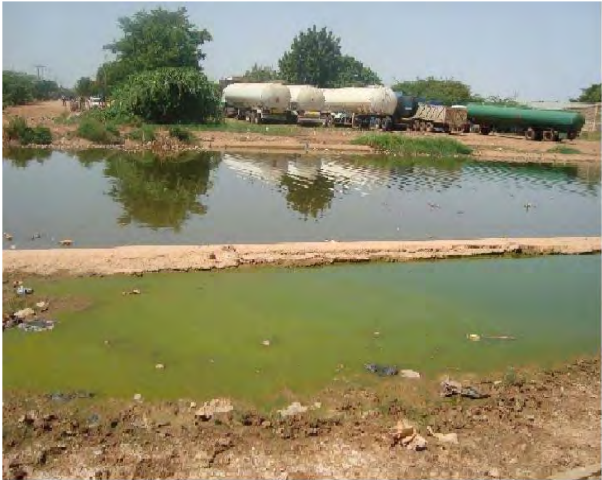
Figure 11 : Un collecteur endommagé
