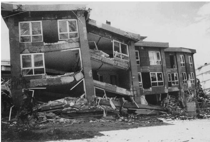
Рис. 1. Ущерб, нанесенный жилым домам
