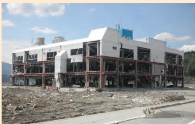
図4 (下) : 浸水を受けても津波に持ちこたえた鉄筋コンクリートの建築物。 車両が屋根の上にあるのに注意
