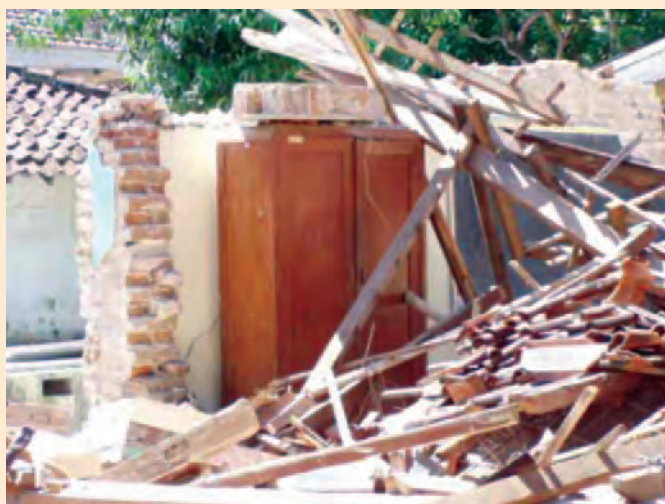
図 12：倒壊した校舎。 棚は倒れていない（ジョグジャカルタ特別州年ジワ島中部地震後）
