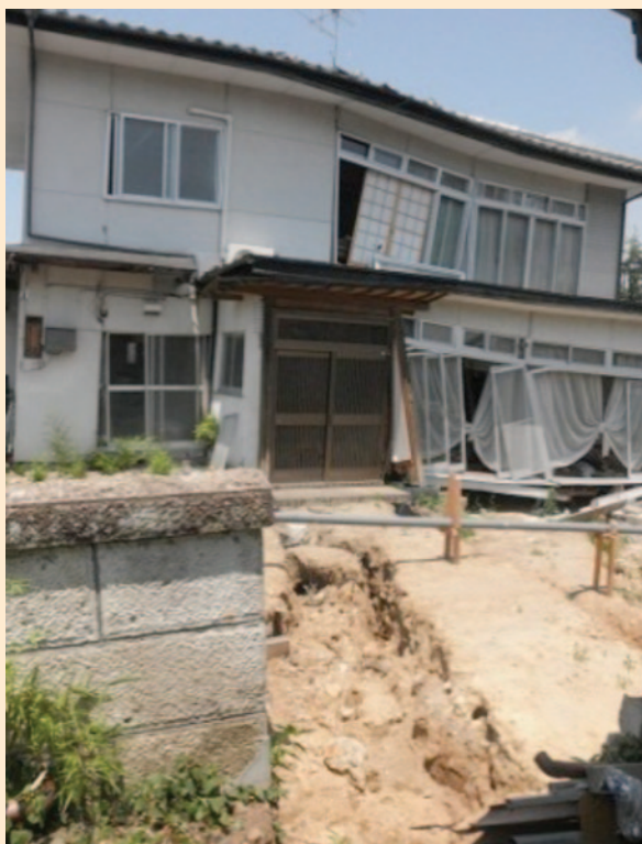
図10：宅地擁壁の被害による損傷を受けた家屋
