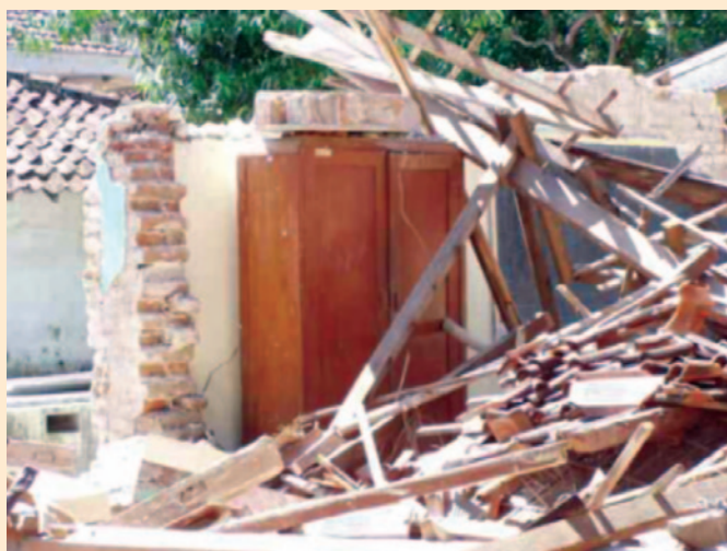
図 12：倒壊した校舎。 棚は倒れていない（ジョグジャカルタ特別州年ジワ島中部地震後）
