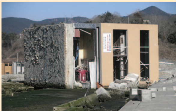
図7 (下) : 杭基礎を用いた鉄筋コンクリートの建築物の転倒
