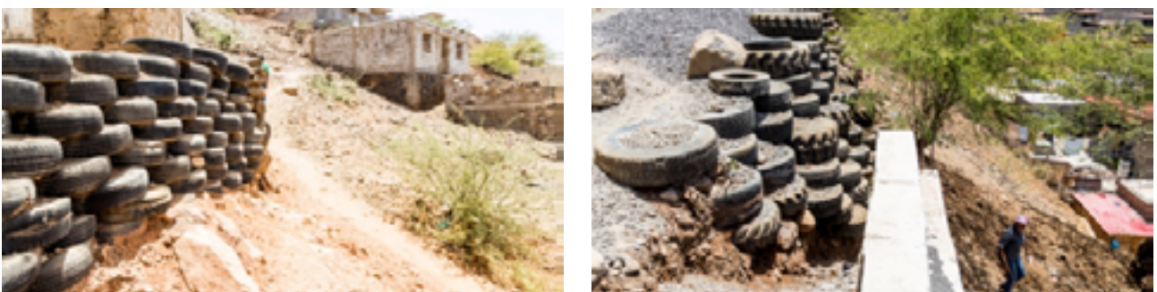
Imagem 10: Estas mitigações de erosão improvisadas podem não suportar a chuva torrencial. As casas abaixo estão diretamente em risco.
