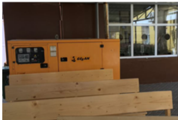
Imagem 17: Centro de saúde na Praia equipado com gerador de energia redundante.
