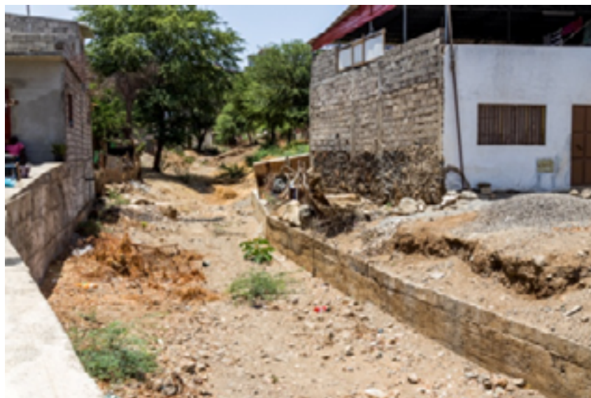
Imagem 8: No bairro socialmente privado de Safende, na Praia, esse canal de drenagem parece ter mais capacidade a montante do que a jusante.
