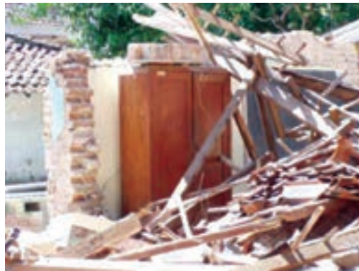
図2.12 倒壊した校舎 棚は倒れていない（ジョグジャカルタ特別州ジャワ島中部地震後）
