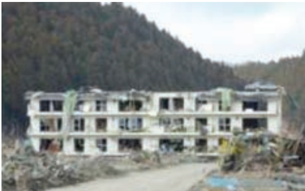
図2.4 浸水を受けても津波に持ちこたえた鉄筋コンクリートの建築物 車両が屋根の上にあるのに注意
