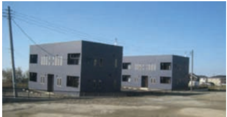
図2.9 液状化による家屋沈下
