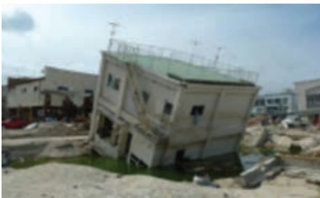
図2.6 津波の洗掘による損傷を受けた鉄筋コンクリートの建築物
