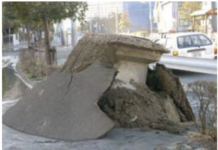
図20.3 浦安市の液状化によるマンホール浮き上がり
