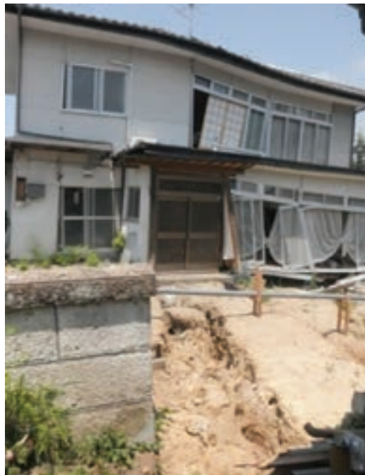
図2.10 宅地擁壁の被害による損傷を受けた家屋
