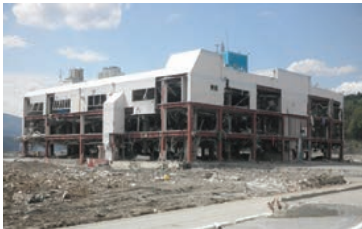
図2.3 津波が鉄骨構造の外壁を破壊
