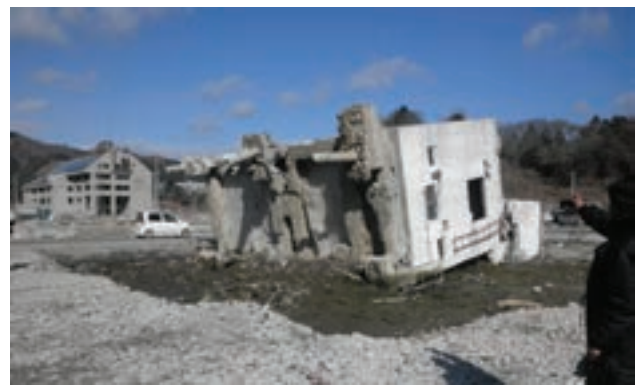
図2.7 杭基礎を用いた鉄筋コンクリートの建築物の転倒
