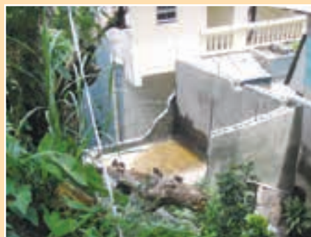
FIGURA 5.15 Factores potenciales de amenaza de deslizamientos: Falla en el diseño y construcción de la estructura de almacenamiento de agua
