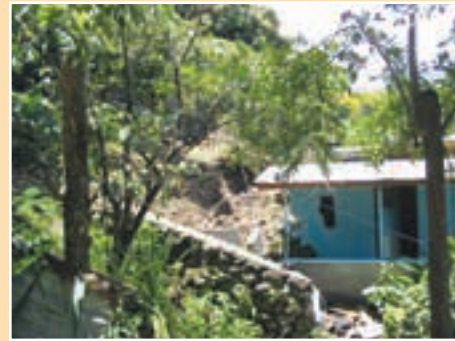
a. Deslizamiento menor donde el impacto de los derrubios ha dañado una casa de hormigón.
