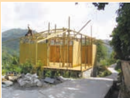
FIGURA 8.16 La ausencia de controles de construcción pueden dar lugar a una construcción inapropiada
