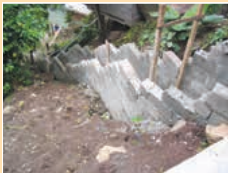
FIGURA 7.31 Drenaje construido con muros laterales a una altura inapropiada
