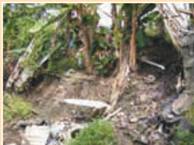
b. Falla en la pendiente causada por falta de gestión del agua de las viviendas no autorizadas en la parte superior de la pendiente.
