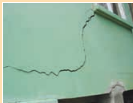
FIGURA 5.17 Grietas en el muro: ¿inestabilidad anterior de la pendiente o mala construcción?
