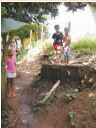
g. Tanque séptico de vivienda descargando directamente a la pendiente.
