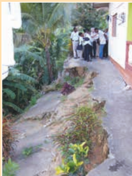
FIGURA 5.13 Factores potenciales de amenaza de deslizamientos: Cortar plataformas para construir casas
