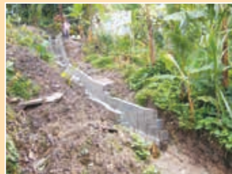
FIGURA 6.18 Prácticas deficientes: La construcción de colectores se inició en la cima de la ladera en vez de comenzar en la base de la pendiente
