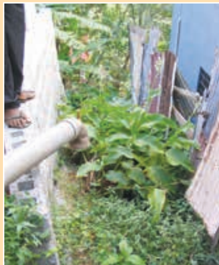
FIGURA 5.14 Factores potenciales de amenaza de deslizamientos: Descarga de agua del tejado y aguas grises directamente a las pendientes
