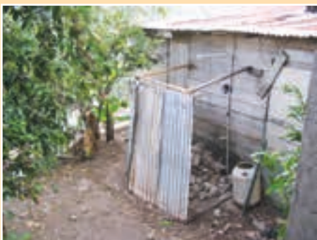
FIGURA 6.38 Captación de aguas grises de duchas y lavaderos
