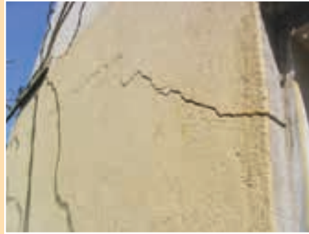
FIGURA 9.7 Evaluación y control de las grietas estructurales
