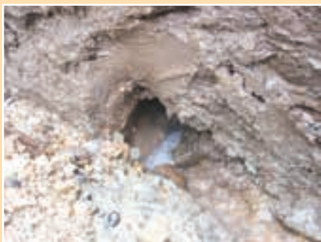
FIGURA 3.21 conducto subterráneo expuesto a unos 30 cm de la superficie
