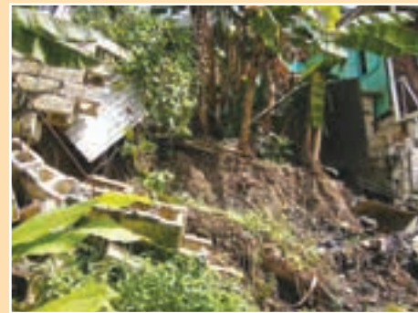
b. Muro de contención que ha fallado, construido por un residente, con la parte más baja del muro movido en la parte posterior de la propiedad.
