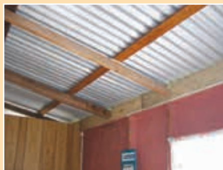
FIGURA 6.42 Estructura de tejado frágil
