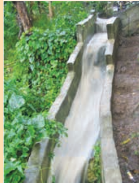
a. El colector de drenaje principal transporta el flujo de un drenaje de interceptación.
