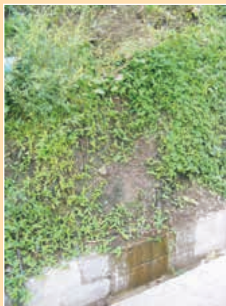
FIGURA 5.11 Filtraciones que ocurren durante temporadas secas donde no hay señales de una zona de convergencia topográfica
