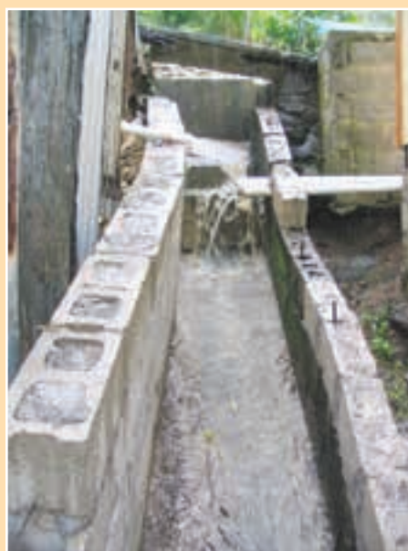
FIGURA 6.39 Conexiones de aguas grises y del tejado a un drenaje de bloque de hormigón
