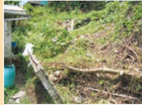
a. Falla típica de un modesto muro de contención construido por un residente.
