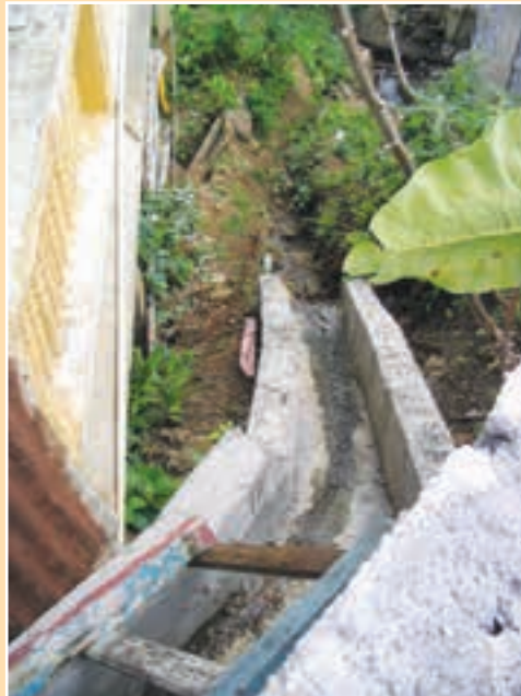
FIGURA 6.20 Drenajes incompletos y dañados
