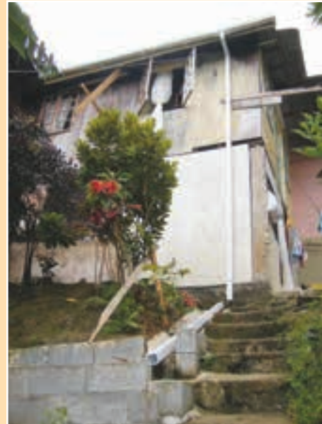
FIGURA 7.6 Conexión de la bajante al drenaje en espera de comprar una parte de la conexión
