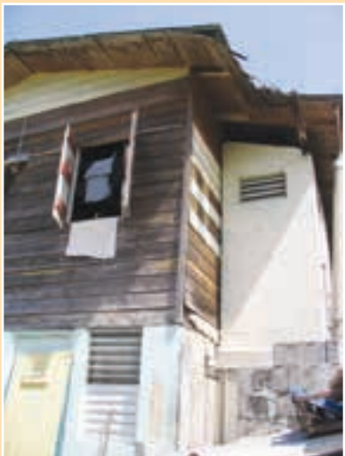
FIGURA 7.22 Problemas en la reparación del tejado
