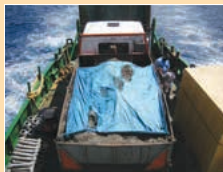
FIGURA 6.28 El envío de material de construcción a la obra puede ser costoso
