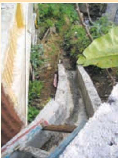
d. Un drenaje que está incompleto y puede por lo tanto causar inestabilidad pendiente abajo.
