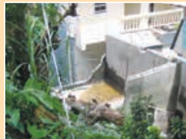
c. Tanque de agua construido con una sola pared de bloques que ha fallado y causado daños considerables pendiente abajo. Tales estructuras pueden desencadenar inestabilidad en la pendiente.
