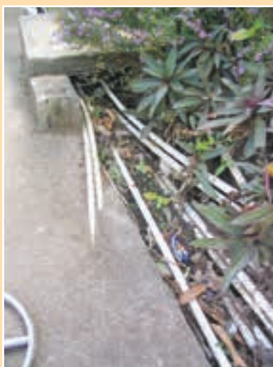
e. Pequeño drenaje sobre sendero que se convierte en completamente inefectivo al tener tuberías de suministro de agua a lo largo de su trayectoria.
