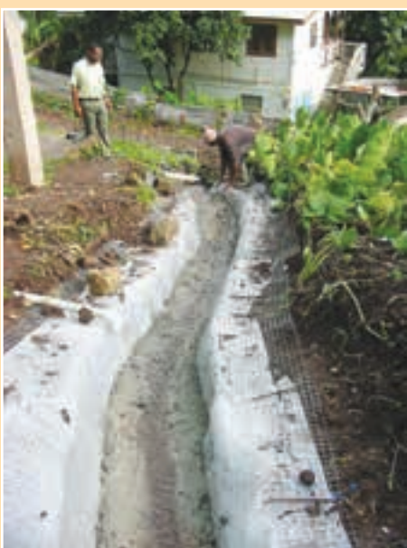
b. Un drenaje terminado con conexiones de aguas grises de las viviendas.
