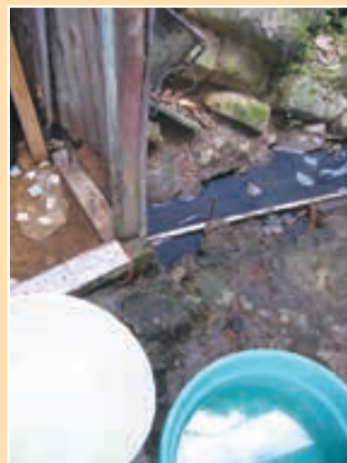
i. Descargas del agua de la ducha y lavamanos a la pendiente produciendo saturación del suelo y agua estancada.
