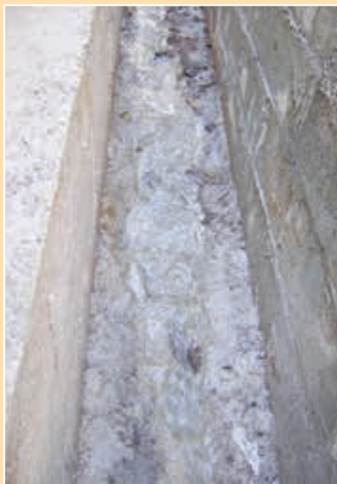
b. Erosión de una base de drenaje vertida recientemente: el refuerzo está expuesto y el agua puede eventualmente romper la base.
