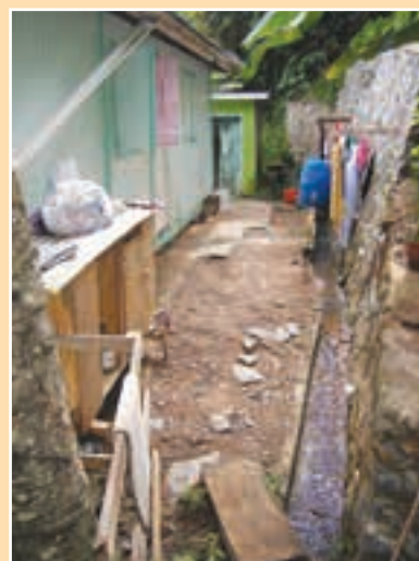
f. Canalones del tejado dañados que descargan sobre un drenaje deficientemente diseñado al pie de un muro de contención.
