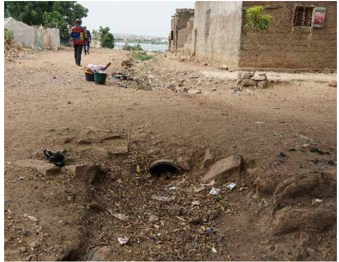
Photo 7 : Obstruction de la buse à l'entrée principale du Groupe scolaire
