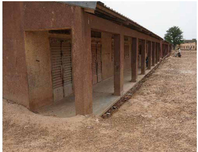
Photo 9 : Cour remblayée plus haute que les salles de classe rendues vulnérables aux eaux de pluie
