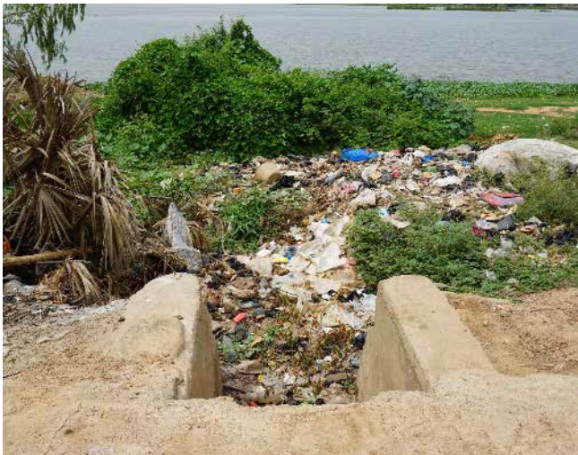
Photo 8 : Exutoire du caniveau vers le fleuve devenu dépôt d'ordures ménagères
