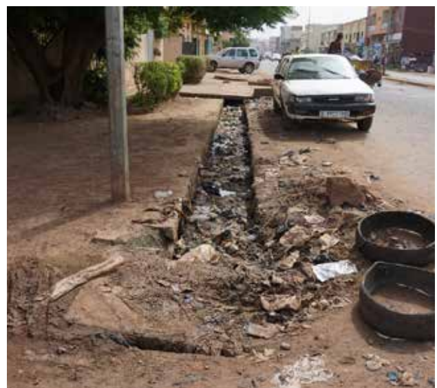
Photo 10 : Caniveau de drainage des eaux pluviales complètement obstrué par des déchets de toutes sortes
