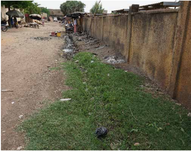
Photo 6 : Caniveau de drainage des eaux autour de l'école complètement obstrué
